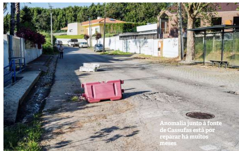
Buraco na rua principal da zona industrial prejudica trânsito na hora de ponta
